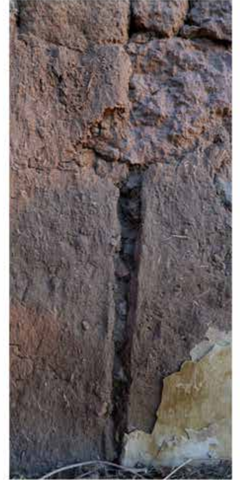
Taş duvarda sabit mobilyanın (yükklük) izi
