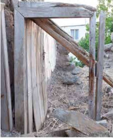
Duvarı yıkılan ahşap kapı
