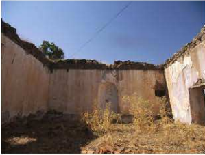
F 5: Mescid mihrab ve zaman içinde yıkılan çatı.
